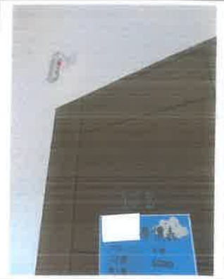
102 緊急照明燈遠拍
