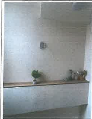
一樓往二樓樓梯間緊急照明燈遠拍
