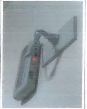
202 緊急照明燈近拍
