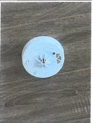
一樓偵煙器近拍
