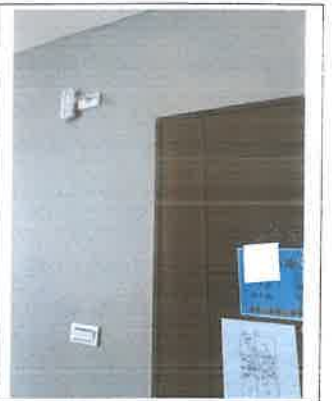
203 緊急照明燈遠拍
