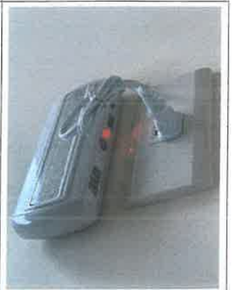
一樓往二樓樓梯間緊急照明燈近拍
