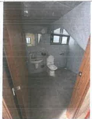
一樓衛浴設備
