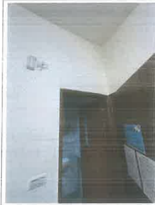
202 緊急照明燈遠拍
