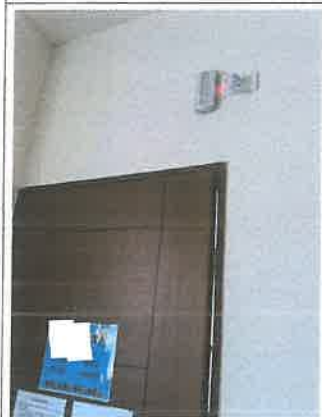
101 緊急照明燈遠拍
