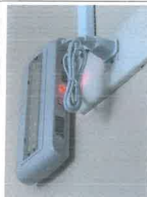
201 緊急照明燈近拍
