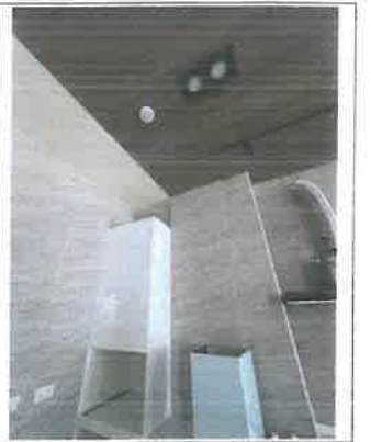
一樓偵煙器遠拍
