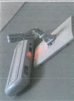
203 緊急照明燈近拍
