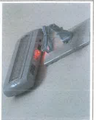
101 緊急照明燈近拍
