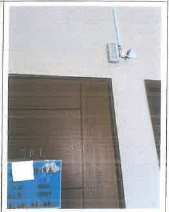
201 緊急照明燈遠拍
