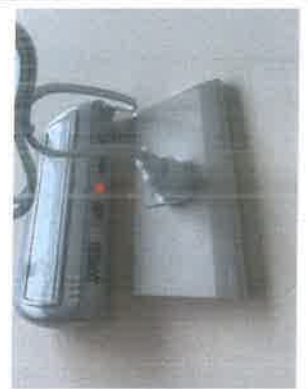
二樓往三樓樓梯間緊急照明燈近拍
