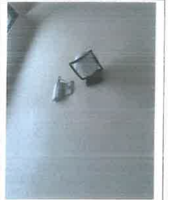
二樓往三樓樓梯間緊急照明燈遠拍
