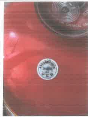
一樓滅火器雷射標籤
